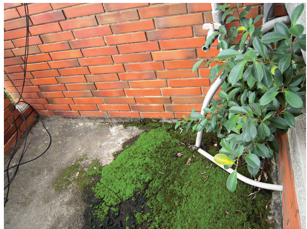
圖二：排水口堵塞
