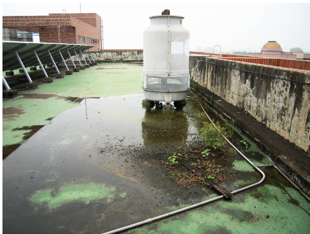
圖一：冷卻塔下樓板下陷
