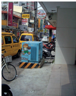
2-2 台灣電力公司變電箱
