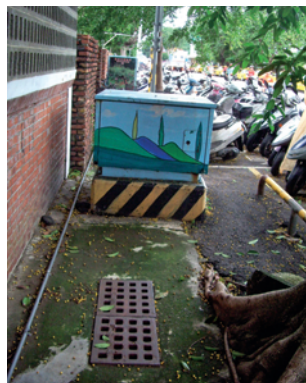
2-1 台灣電力公司變電箱
