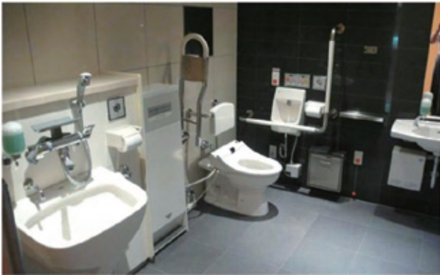
照片2 日本TOTO Technical Center新設計的行動不便廁所，左角有人工肛門洗盆行動不便馬桶側牆小洗手盆、沖水鈕、求救鈴，馬桶除了扶手外有靠背。(吳明修攝)
