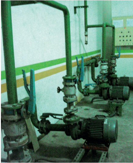
設備老舊耗能且運轉具噪音干擾
