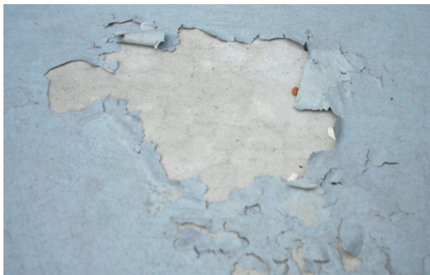
屋頂防水隔熱層劣化
