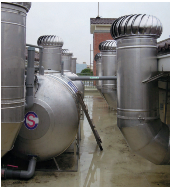
屋頂裝設自然通風塔
