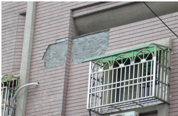
軀殼壁體磁磚剝落滲水
