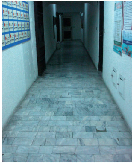
走廊密閉通風不良
