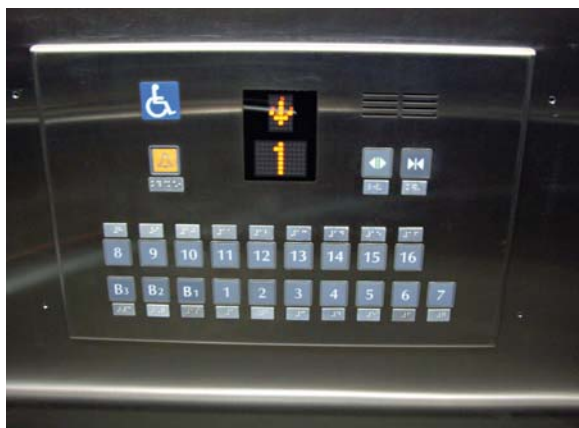
電梯副操作盤
