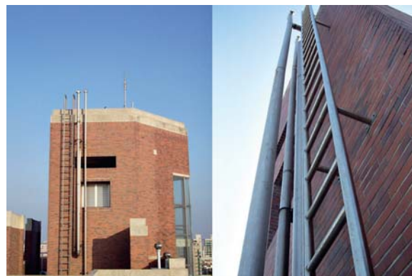
圖3 太高的爬梯未做護欄，管理員不敢爬。
