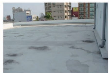
屋頂地坪洩水坡度不良積水
