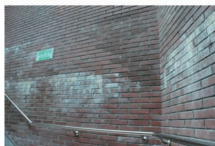
壁面滲水白華磁磚剝落
