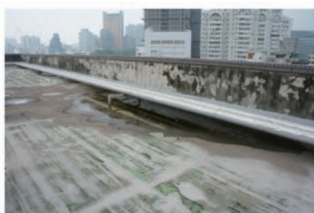
屋頂排水不良積水
