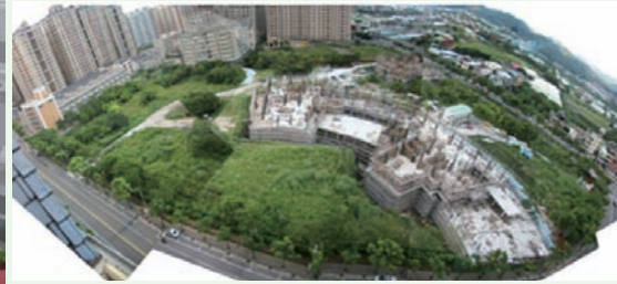
營造廠依圖施工進行中——設計者與營造者的分野，在營造過程中變得模糊，常造成權責不明。
