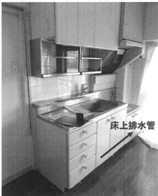
圖 1 系統廚具(注意照片示意排水管方向) 照片中「床上排水管」之「床上」意指同層(當層)，「床上排水管」字眼箭頭方向，意指系統廚具的內側位置，設置採用樓板上方的同層排水。廚具水槽下內側設置牆前式排水管道，採直接貫穿外牆連通至外側服務陽台的垂直管道間主立管。
