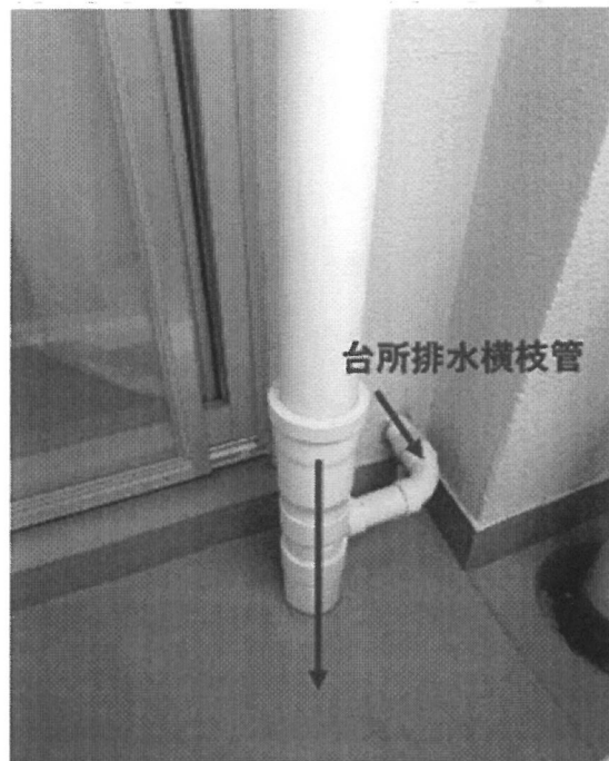
圖 2 服務陽台上垂直管道(注意排水方向) 照片中「台所排水橫枝管」之「台所」意指系統廚具。圖中箭頭向外方向，意指系統廚具採牆前式同層排水由室內排水至室外垂直管道間主立管。社宅服務陽台洗衣機、陽台地坪排水，亦可藉此主立管排水。另，主立管可外露或設置於易維護修繕管道間內。
